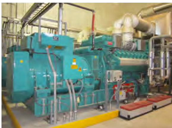
Dos grupos electrógenos a gas natural de Cummins entregan energía auxiliar a la Universidad del Estado de Washington, en Estados Unidos.
