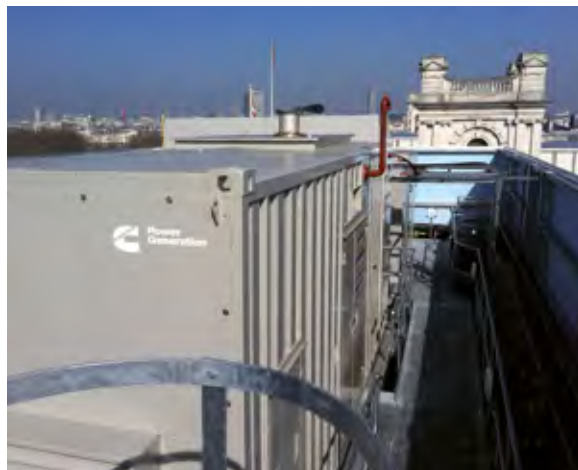
Cummins ESB instaló un generador auxiliar a gas natural en el Instituto de Ingenieros Civiles de Londres.
